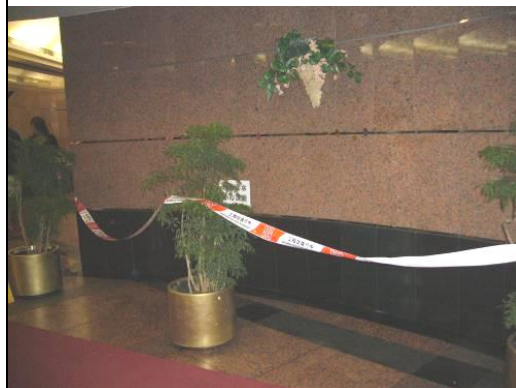
大堂保安對出都滲水
