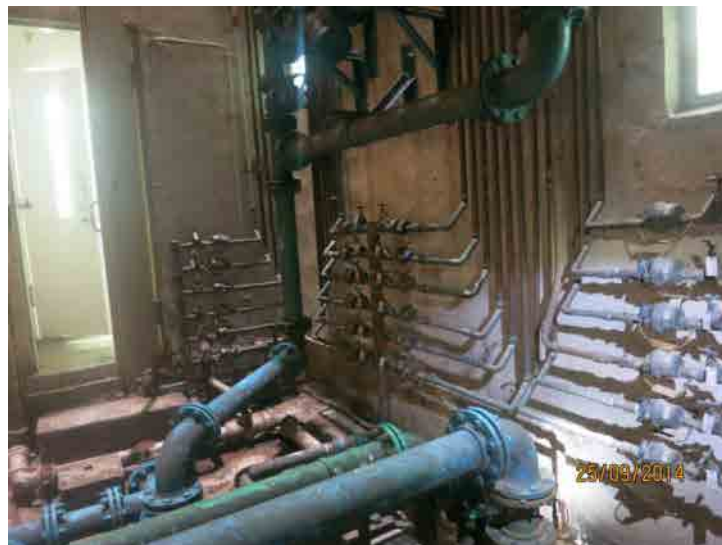
康輝閣1樓天井位置(個別單位食水喉漏水弄濕天井地台)
